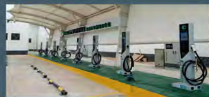
上海捷泰充电站
